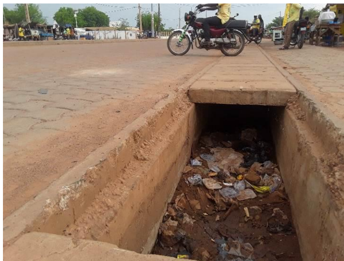
Photo 8: Caniveau bouché par des déchets à Banikoara
