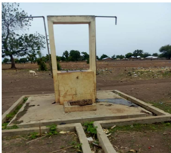
Photo 7 : Borne Fontaine mal entretenue à Arbonga Prise de vue : Cabinet PIC, mai 2019
